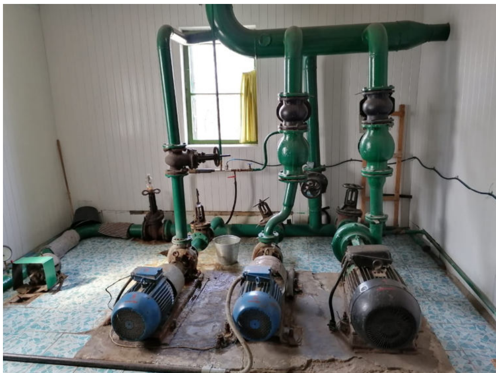
Рис. 5 Водогрейные Котлы КВа-0,63Гн, установленные в Котельной № 3 г.Калач-на-Дону
