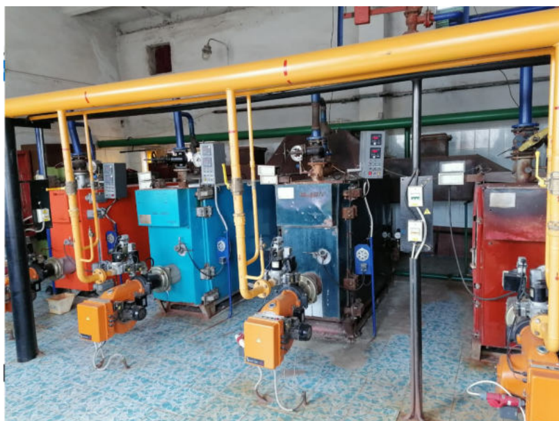
Рис. 4 Водогрейные Котлы КВа-0,63Гн, установленные в Котельной № 3 г.Калач-на-Дону
